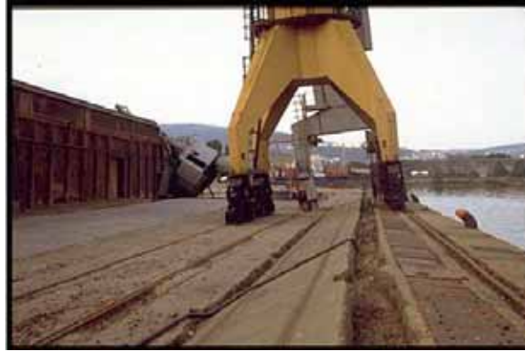
Şekil 2. Derince Limanı Kocaeli Depremi 1999 Sıvılaşma nedeniyle oluşan deformasyon (Limas)
